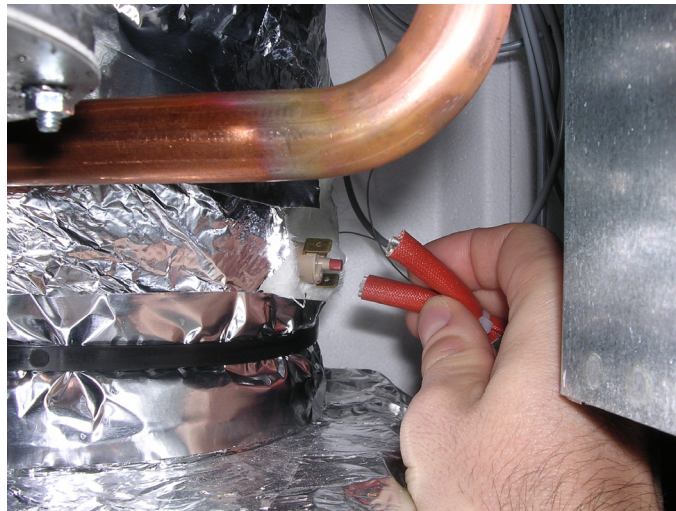
Abbildung 2 – Kontrolle des Übertemperaturschalters des Generators
